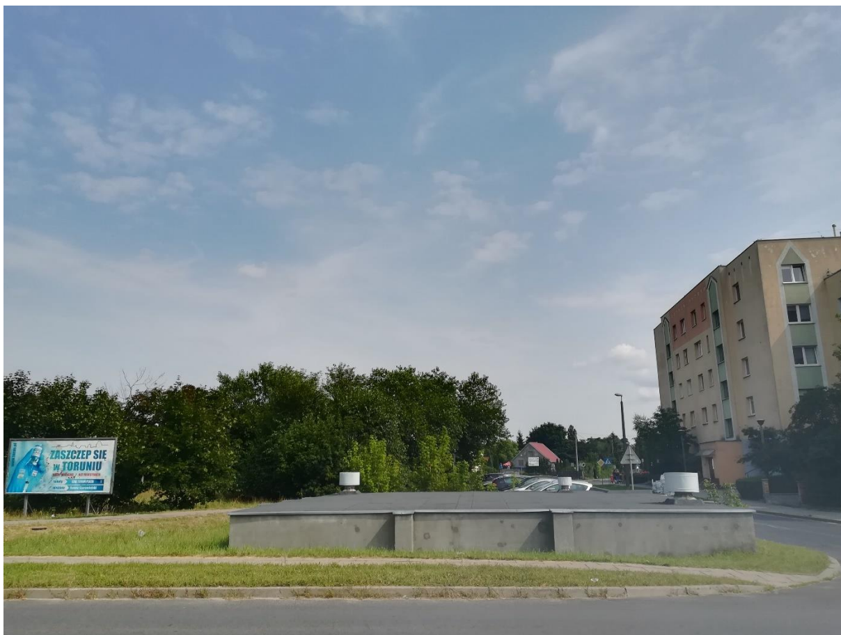
Fotografia 2. Komora cieplna w zachodniej części analizowanego obszaru
